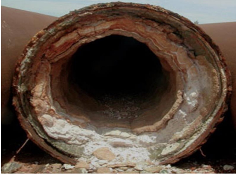
Şekil 12: İçme suyu boruları zamanla korozyona uğrayabiliyor.
